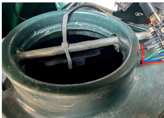
Le capteur "Sonar" installé sur la cuve de GNR du Chapitre
